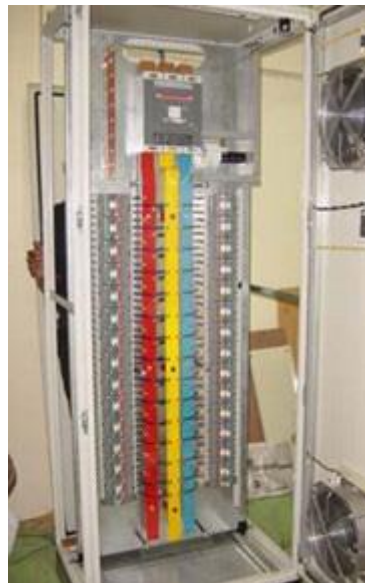
รูปที่ 2.9 BUSBAR ใน ตู้MDB (Main Distribution Board)
